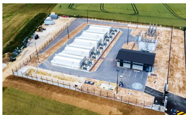
Les systèmes de stockage de l'électricité par batteries raccordés au réseau public d'électricité ont une puissance unitaire de 1,25 à plus de 100 MW. Photo : projet RINGO, RTE.
