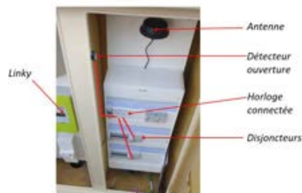
Exemple d'armoire avec horloge connectée à Mayenne
